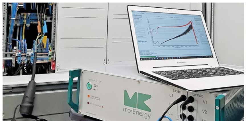
Bild 1. Messung und Datenanalyse der bestehenden Power-Quality
